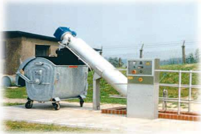
الشكل (11) المصفاة Rotamat RO9 من شركة Huber الألمانية
